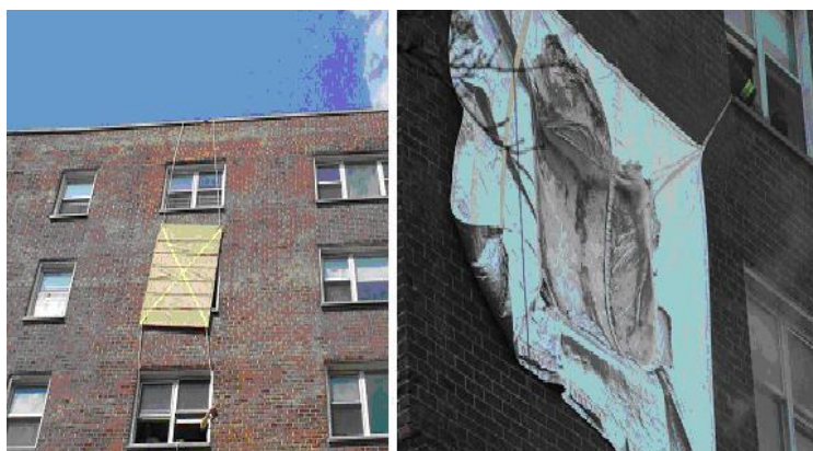
Illustration n°1 : Installation d'un dispositif stoppant le vent dans un volume en feu (NIST)
