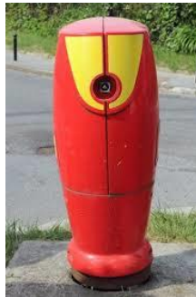
Illustration n°8 : Exemples de poteau sur canalisation de 150
